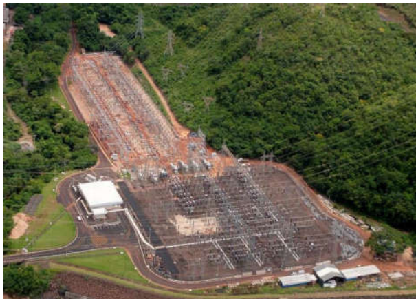
Fig. 1a: Vista aérea da subestação de Mascarenhas de Moraes (20.28S, 47.06°) localizada no município de Ibiraci, Estado de Minas Gerais. Fonte: Eletrobras (Centrais Elétricas Brasileiras S/A.).
